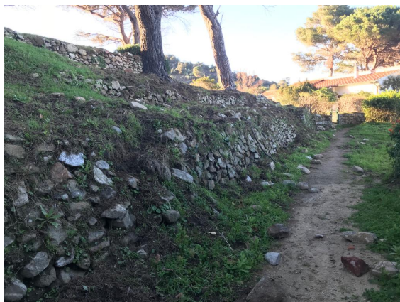
muri a secco distrutti
