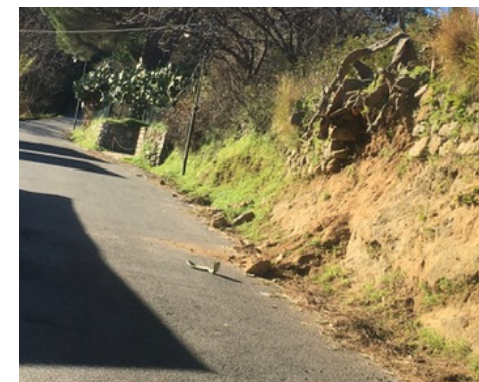
carreggiate stradali costantemente invase da pietre e terra spostata dagli ungulati
